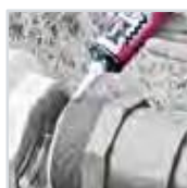
▪ Fluidos de refrigeración
